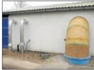
Warmte-, lucht- en waterleidingen (foto: Rob Essenberg).
