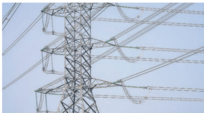
Hoogspanningsmast. Foto: Bigstock.
