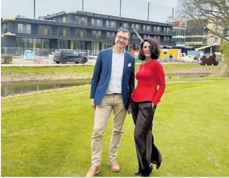
Algemeen manager Bernard Lensink en HR-projectmanager Mirjam Swart met op de achtergrond het in aanbouw zijnde hotel. Foto: Spaarnwoude Park Hotel.
